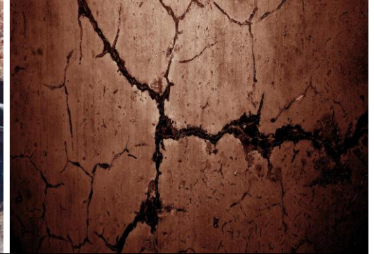
Grietas en paredes y pisos
